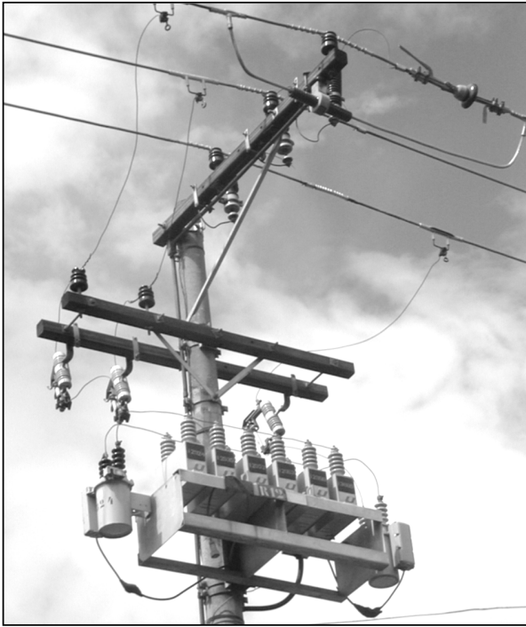
Fig. 1. Estrutura padrão - B.C. automático por corrente instalado na rede de distribuição primária da CPFL.
